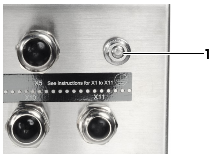
Figura 52: Bullone di messa a terra
