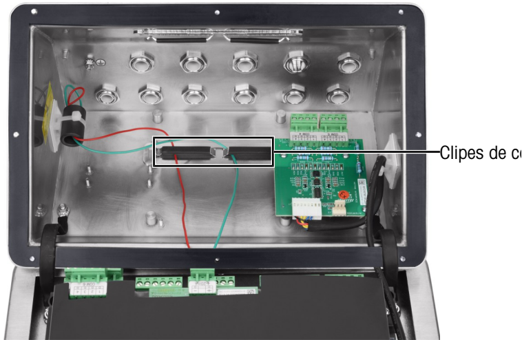
Figura 13: Utilização de clipes de cabos
