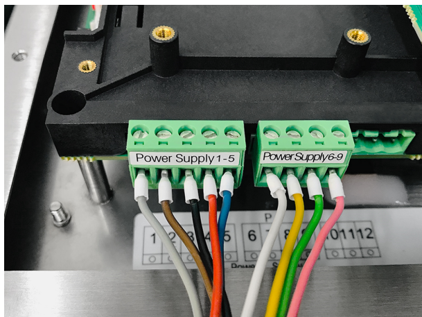
Figura 19: Terminação de energia
